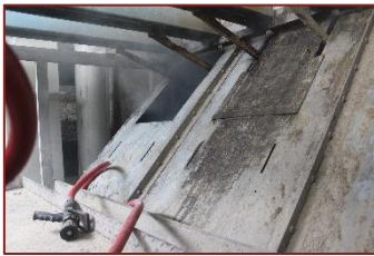
Trappes de visite du distributeur pendulaire
